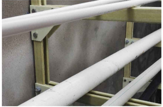
电缆支架 Cable rack
